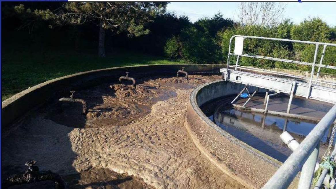
Bassin d'aération et clarificateur
